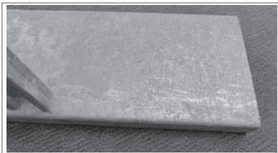
شکل ۷: نمونه‌هایی از شوره زدگی سطحی و جزئی پوشش گالوانیزه گرم قطعات صنعتی
