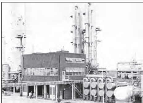
تصویر (8): تاسیسات سردسازی در یک کارخانه پتروشیمی. در ساختمان نشان داده شده، کمپرسورهای سردسازی نصب شده‌اند که به 6500 کیلووات توان برقی نیاز دارند. سایر تجهیزات مربوط به سردسازی در کنار ساختمان کمپرسورها نصب شده‌اند.
