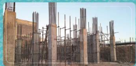
اجرای داربست‌های تیر اصلی و فرعی سقف اول زیرزمین زون مرکزی مرحله اول
